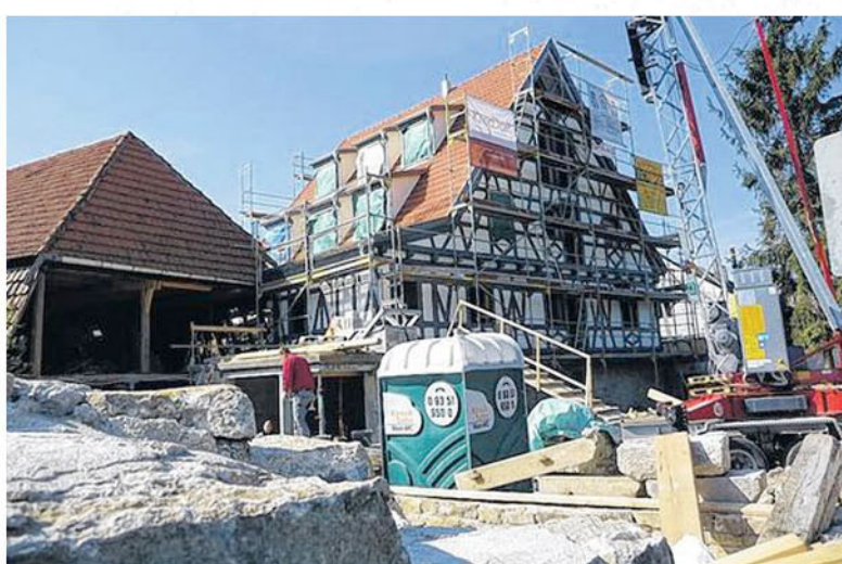
Mitten im Bau: Das Haus von der Mainbrücke aus betrachtet. Links im Bild die Scheune, die ebenfalls ausgebaut wird
